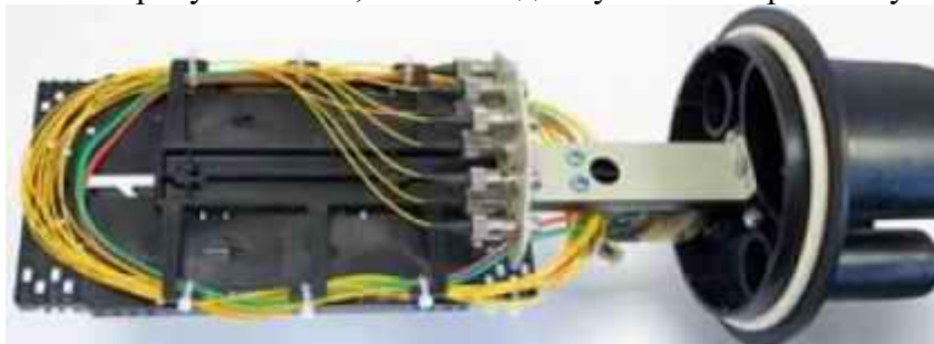
Рисунок 4.10 – Укладка и крепление запаса длин ОМ и pigtail
